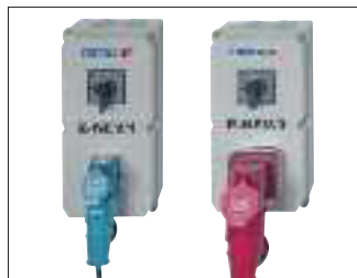
Einspeisungsverteiler Ausführung mit 230 V oder 400 V erhältlich.
